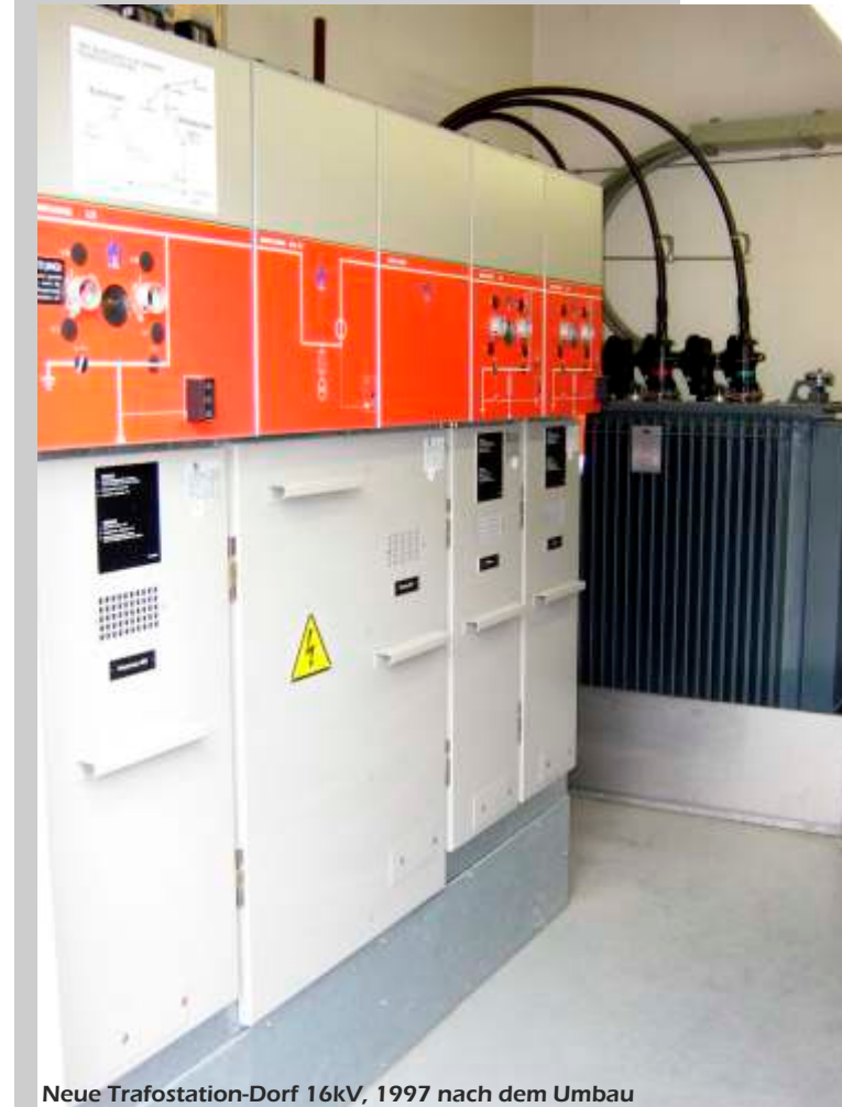
Neue Trafostation-Dorf 16kV, 1997 nach dem Umbau
